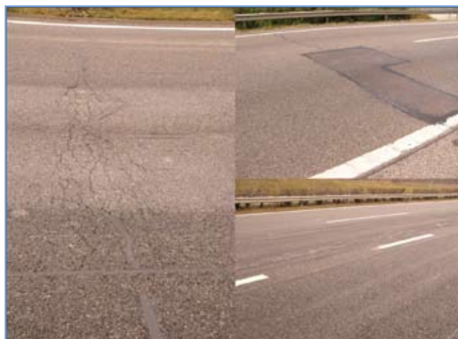
4. ábra: Reflexiós repedés, lokális teherbírásvetés és plasztikus deformáció a burkolaton
