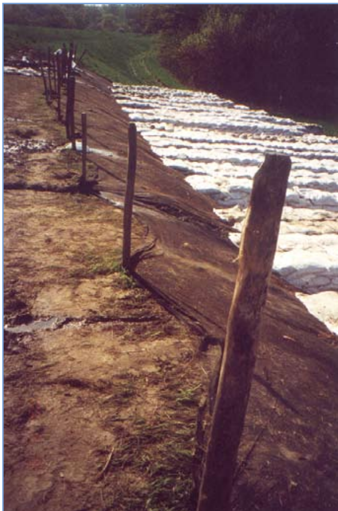
3. ábra: Kúszó talajtömeg által elvonszolódt geotextília
