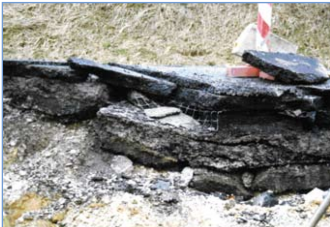
2. ábra: Aszfalttal pótolótt útburkolati süllyedés. A fényképfelvétel nem a teljes burkolatsüllyedési javításról készült
