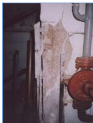
3. ábra: Károsodott pillér előlről
