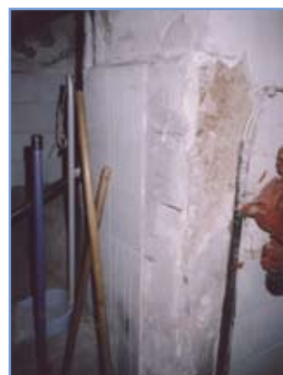
4. ábra: Károsodott pillér oldalról
