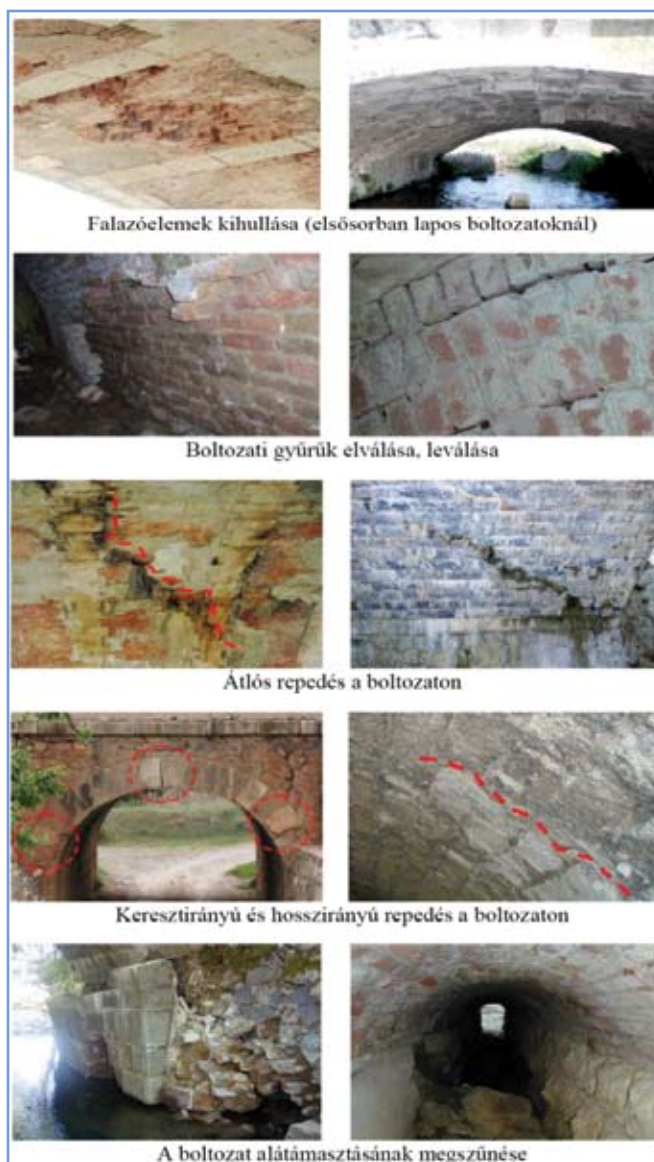
3. ábra: Jelentős teherbírás-csökkenést okozó károsodások
