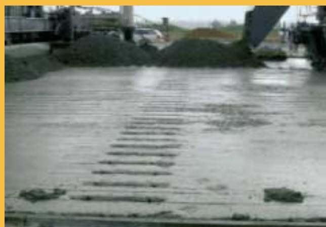
7. ábra: Az alsóbetonba bevibrált kereszthézagvasak nyoma a közbenső betonfelületen
