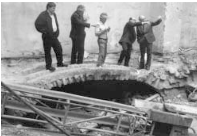
3. ábra: Felvétel a tönkrement kétraktusos pinceboltozatról, háttérben a nyílással áttört középső főfal ny-i vége
