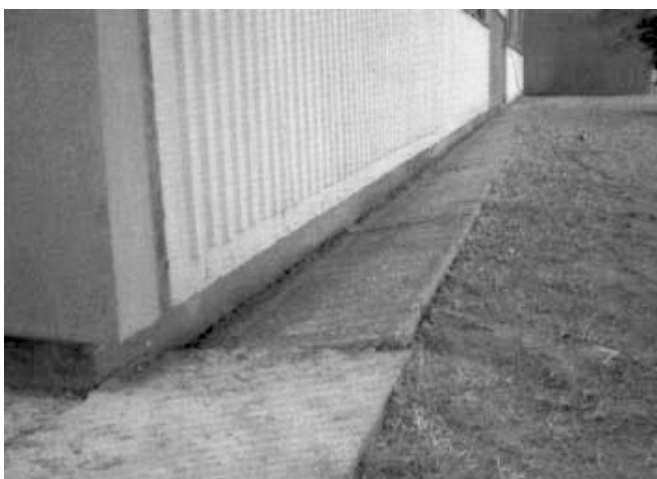
10. ábra: A süllyedő fal magával húzta az épület körüli járdát
