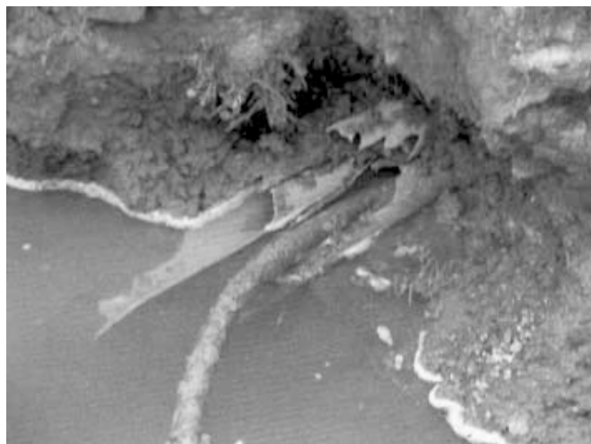
3. ábra: A három (barna) PVC cső, amely a csőtörés vizét az épület mögé vezette
