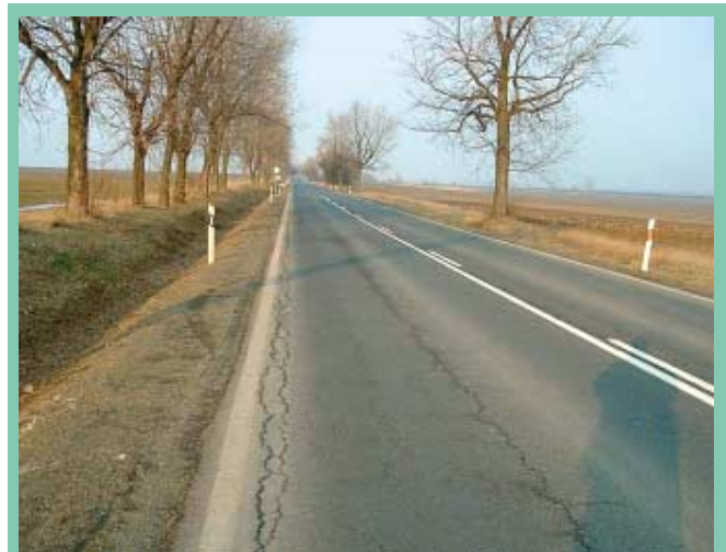
10. ábra: 3. út, 214+700 km. Hosszrepedések a szélesítések vonalában
