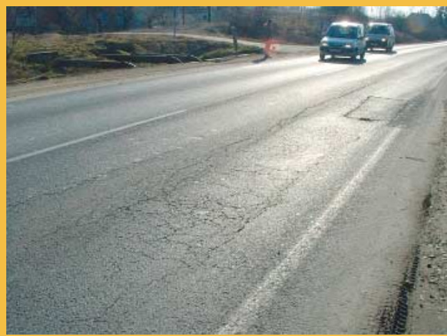
4. ábra: 35. út, 21+800 km. Hossz- és teherbírési repedések, deformációk; a tönkremenetel jelei
