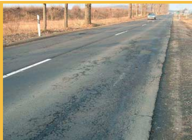
9. ábra: 3. út, 207+400 km. A burkolat állapota
