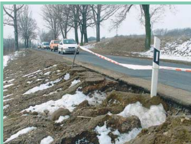
1. ábra: 3. út, 227+300 km. Az útpadka eróziója, a szegély leszakadása
