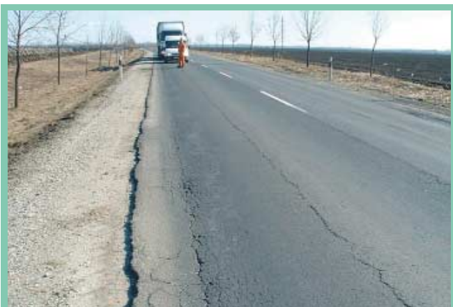
14. ábra: 35. út, 60+800 km.
