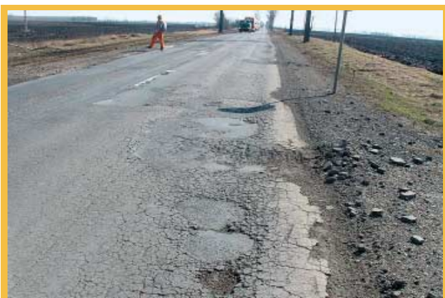
13. ábra: 35. út, 44+600 km. Kritikus burkolatállapot
