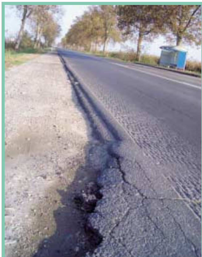
2. ábra: Padka és burkolatszél (47. sz. főút)
