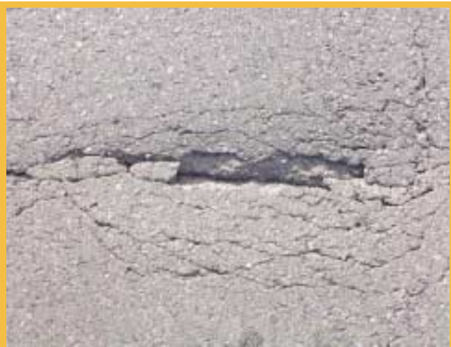
5. ábra: Burkolati hiba részlete (42. sz. főút)
