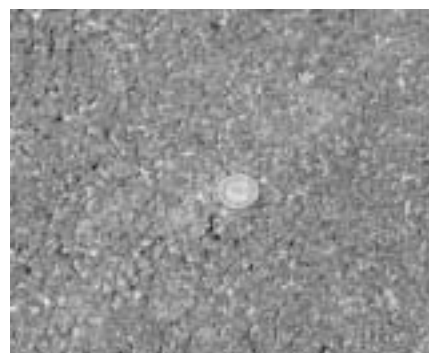
5. ábra: Kopóréteg a 4. sz. főút 58+200 km-szelvényében
