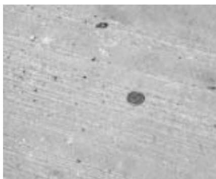
4. ábra: Kopóréteg a 4. sz. főút 58+600 km-szelvényében
