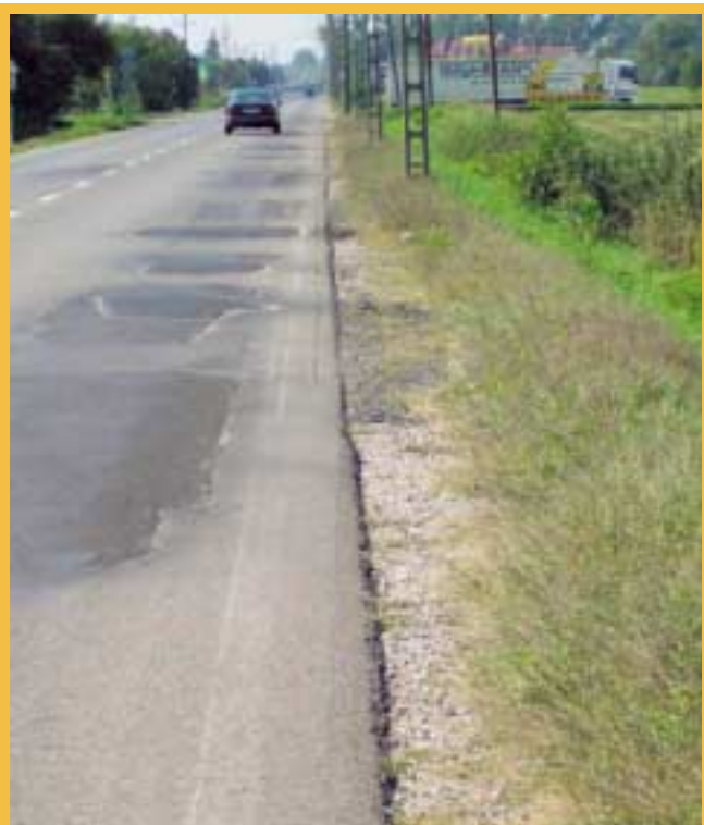
7. ábra: Kátyúzás után (42. sz. főút)
