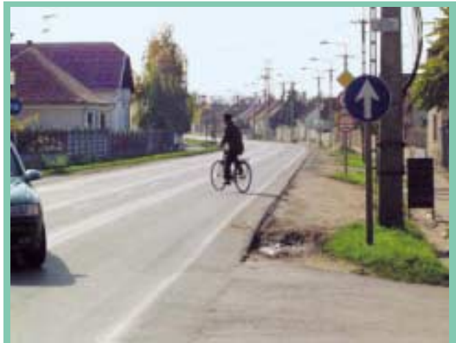
6. ábra: Nyomvályús útszakasz (47. sz. főút)
