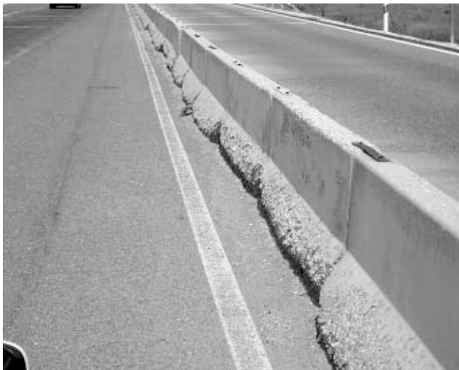
1. ábra: A nem megfelelő betonminőség következményei
