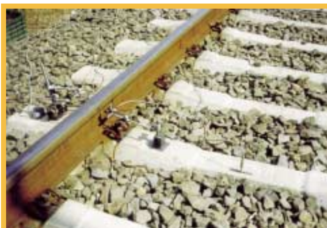
1. ábra: Rákospalota–Újpest és Dunakeszi állomás között a bal vágány felépítménye
