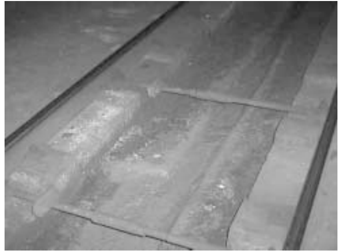
1. ábra: Nyomtávbiztosító rudakkal felszerelt vágány
