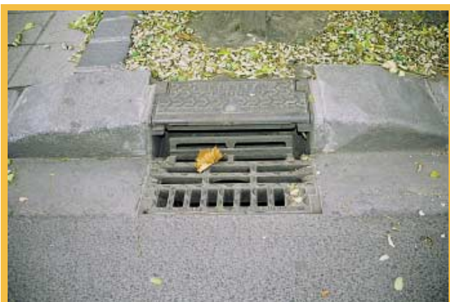
3. ábra: Oldalbeömlésű víznyelő a Dózsa György úton
